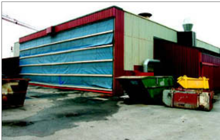
PRODUKSJONSHALLEN: I denne hallen, inne på Kleven-verftet sitt område, pågår arbeidet for fullt med den første Sunquest-yachten. Foto Roger Elltvik
